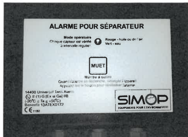
Boîtier alarme SIMOP
